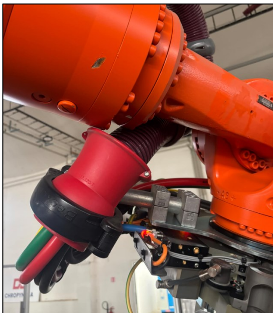
Obrázek 75: Kolize vstupního pouzdra s ramenem robotu
