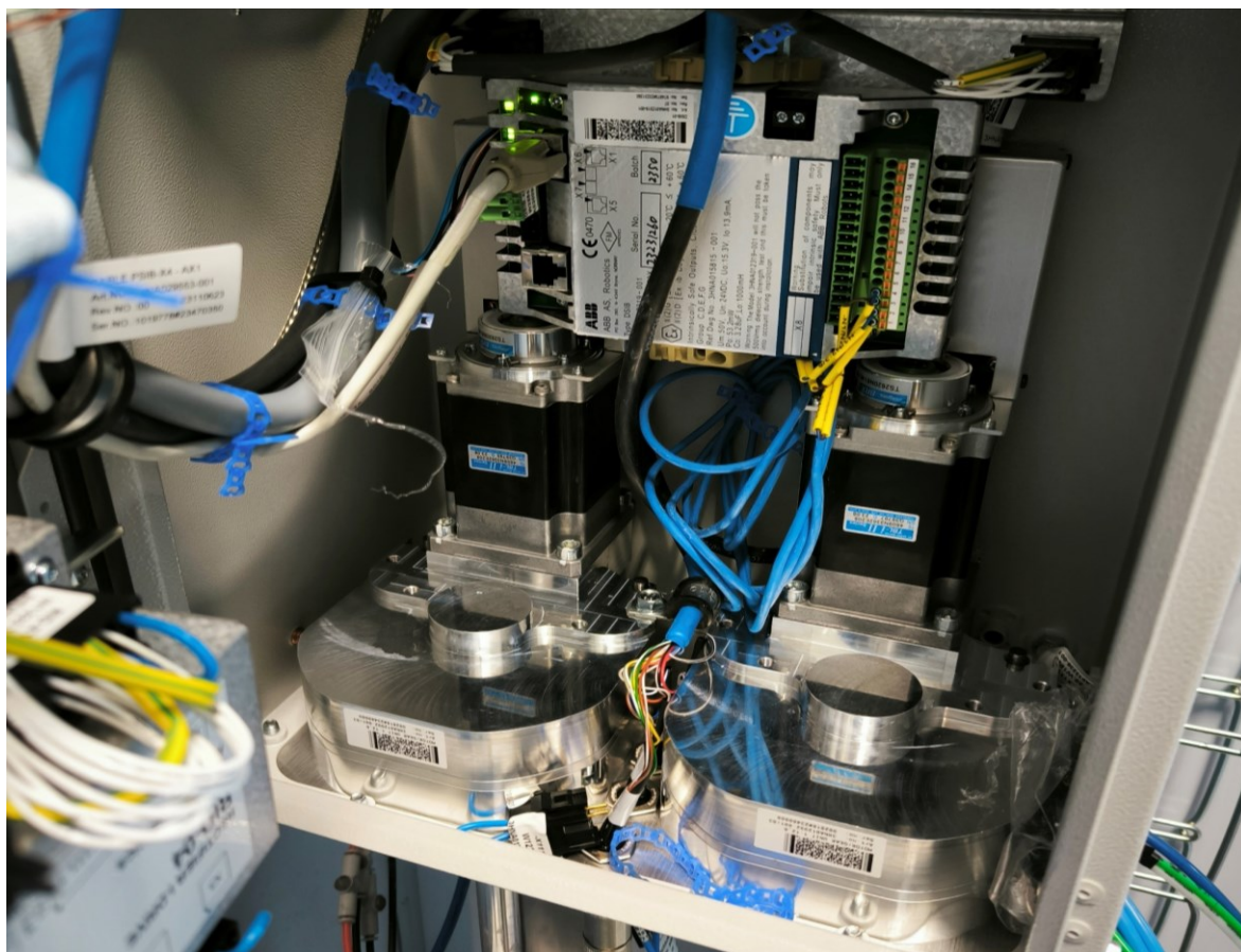
Obrázek 38 Rozvaděč pohonu čerpadel [65]
