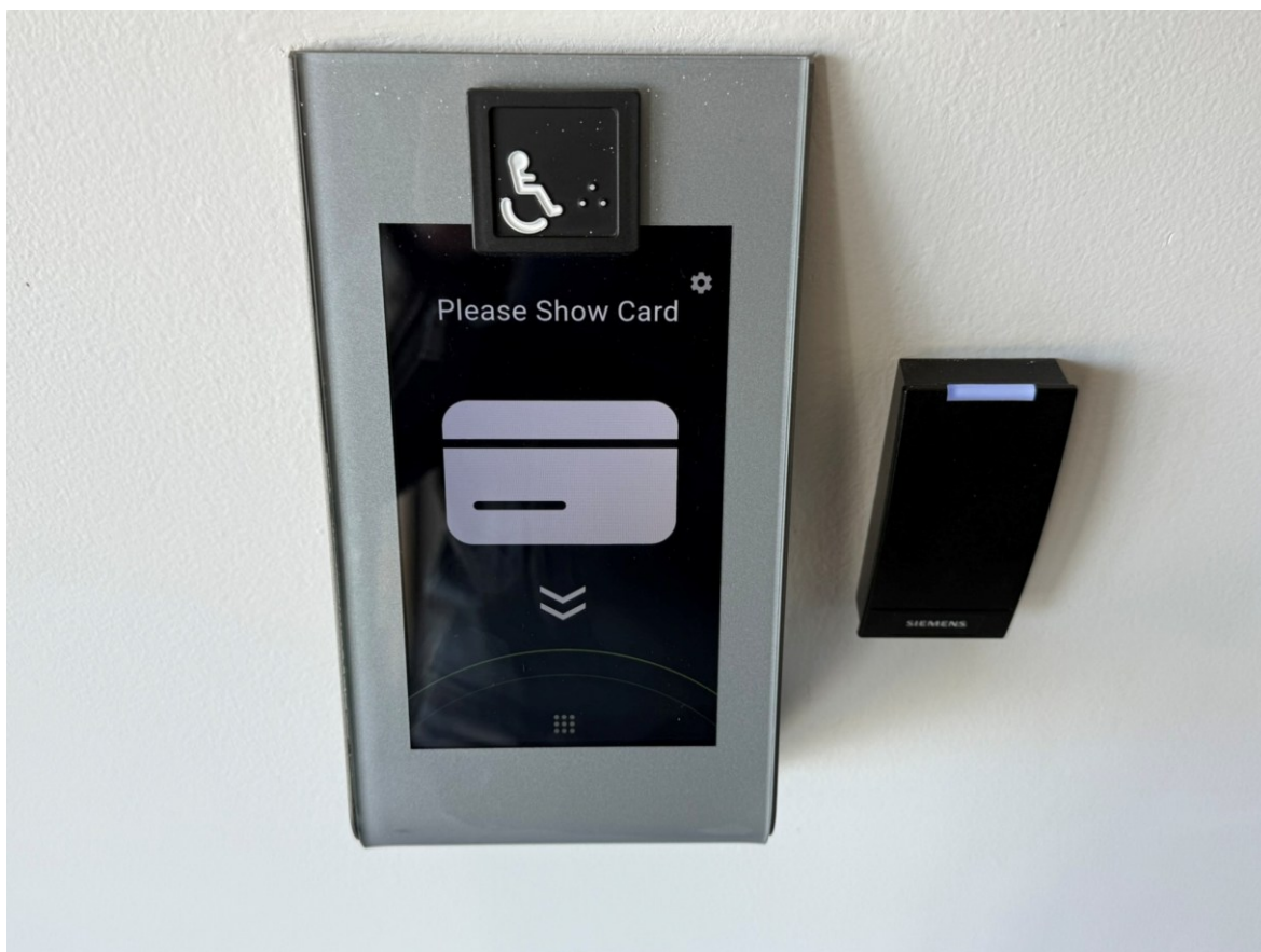
Obrázek 19 Přístupový systém pro ovládání výtahů
