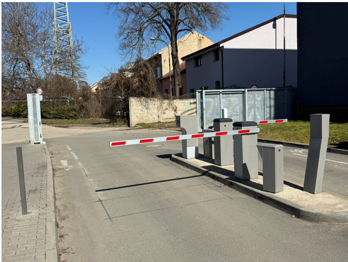
Obrázek 5 Automatické závory v severní části
