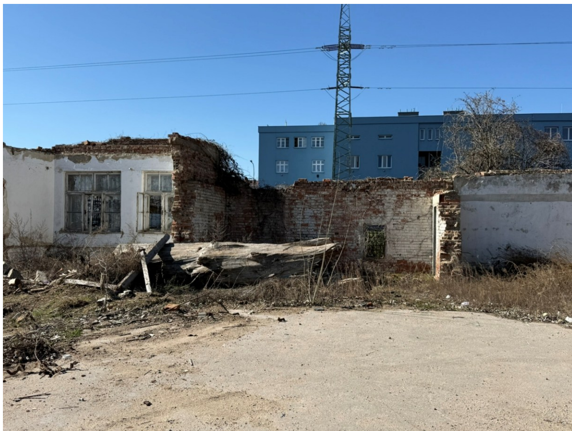
Obrázek 14 Ruiny v západní části před opravou
