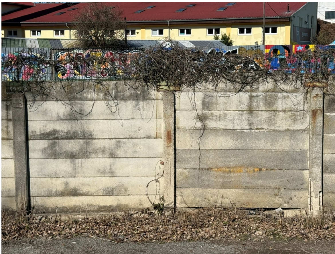
Obrázek 16 Špatný stav MZS v severozápadní části
