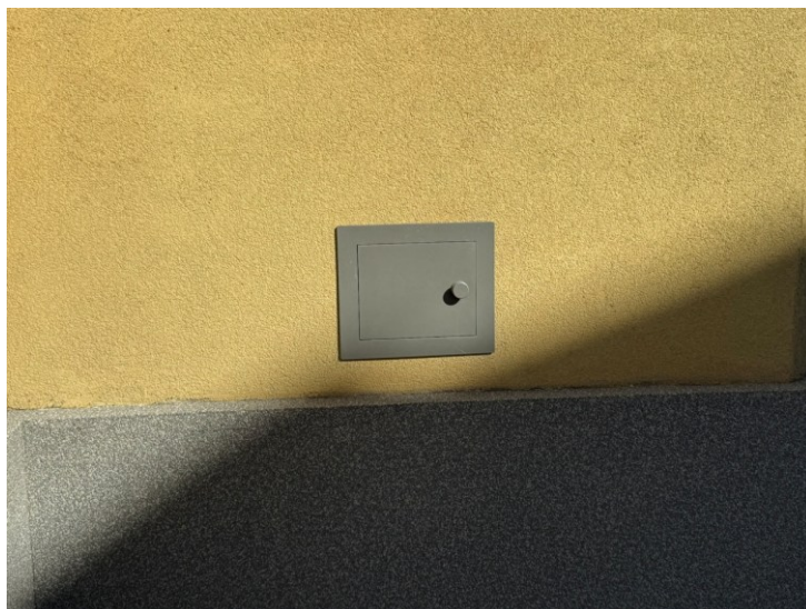
Obrázek 10 KTPO umístěné v plášti objektu
