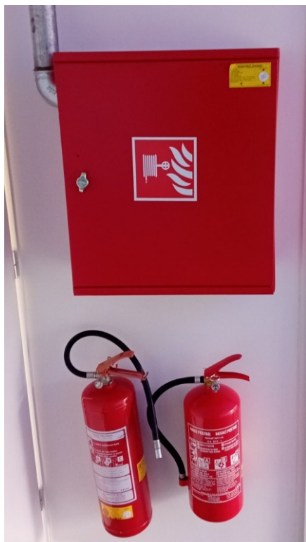
Obrázek 11 Požární hydrant a hasicí přístroje
