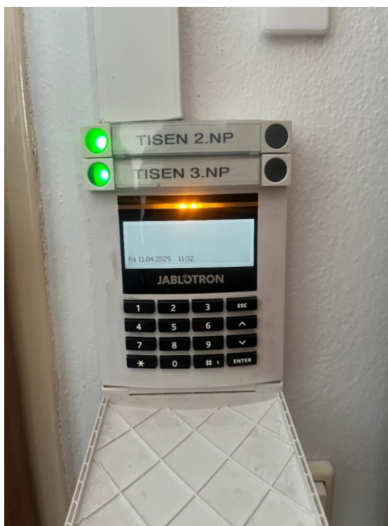
Obrázek 41 PZTS v kanceláři vedoucího odboru
