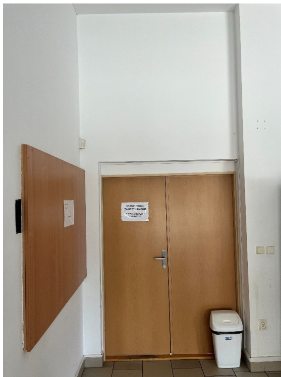
Obrázek 13 Dveře k prostoru ke vstupu od dvora a pohybové čidlo
