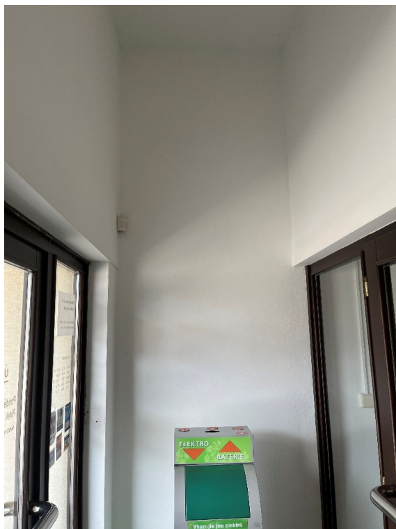
Obrázek 14 Pohybové čidlo u hlavního vchodu
