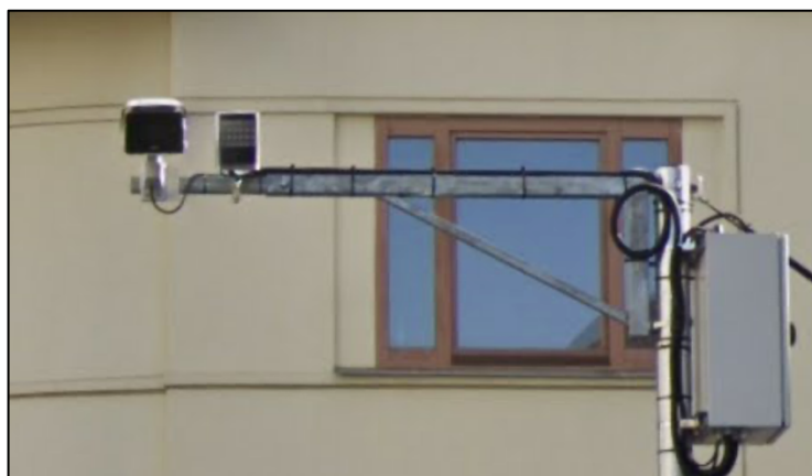
Obrázek 14 Senzor, ukázka instalace, město Brno
