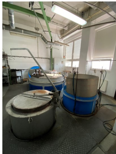
Obrázek 24 Pracoviště tepelného zpracování (vlastní zdroj)
