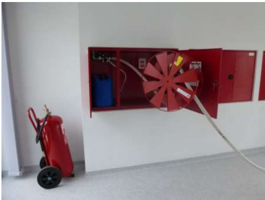
Obrázek 4 Hasicí zařízení heliportu
