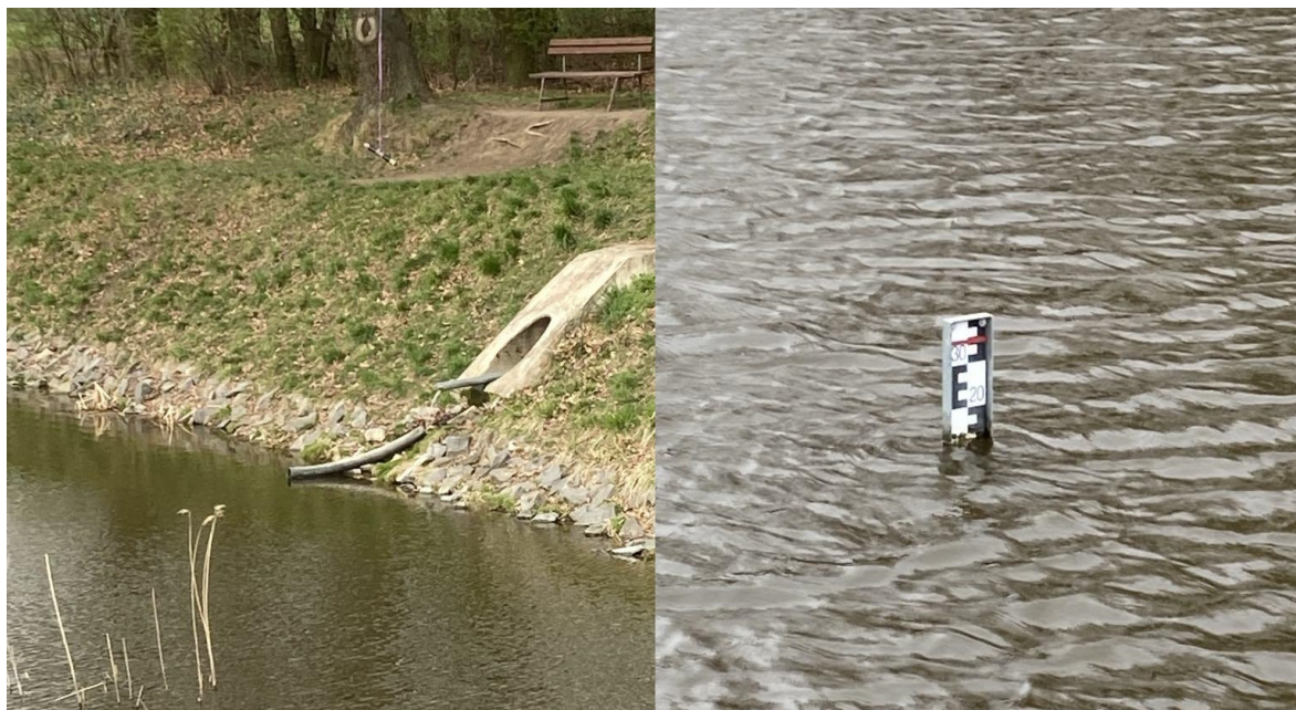
Obrázek 25 Výpustní zařízení nádrže (vlevo) a vodočetná lať pro sledování výšky hladiny (vpravo)
