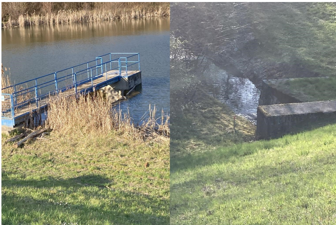
Obrázek 27 Výpustné zařízení (vlevo) a odpadní koryto s bezpečnostním přelivem (vpravo) u malé vodní nádrže Mojena
