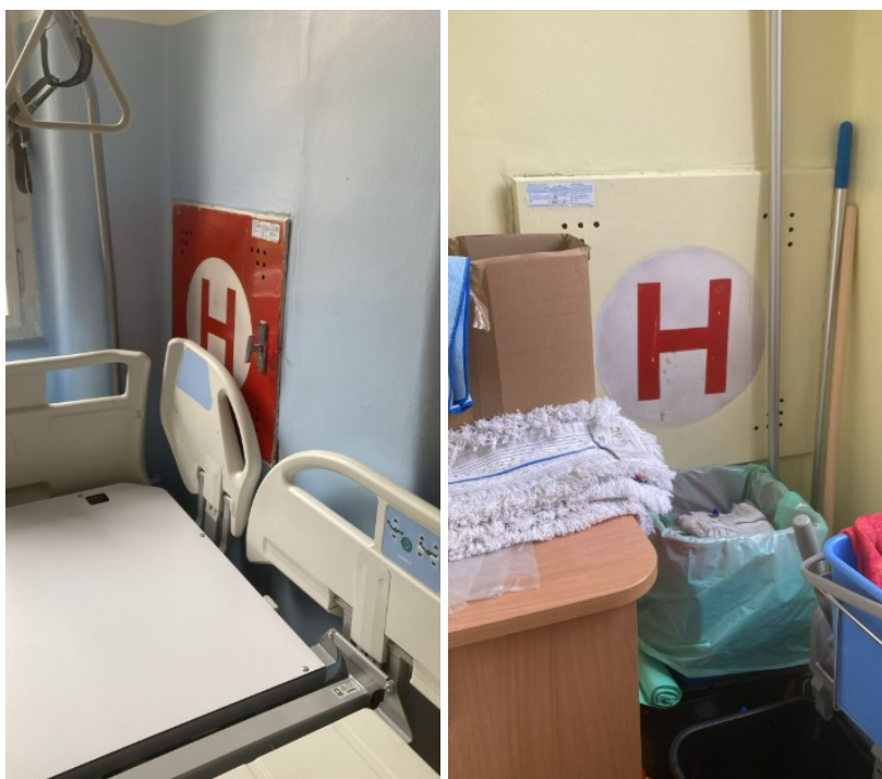
Obrázek 2 – Hydranty ve Fakultní nemocnici Bulovka, které jsou zjevně obtížně dostupné (Zdroj: Vlastní zdroj, 2025)
