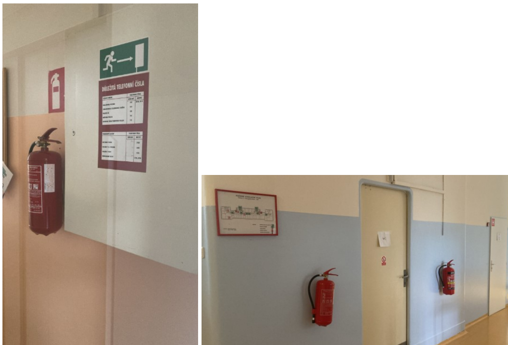
Obrázek 1 - Správné umístění a označení hasicích přístrojů (Zdroj: Vlastní zdroj, 2025)
