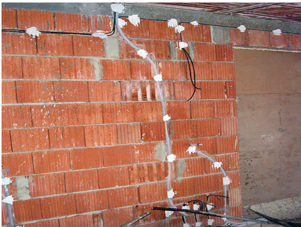
Obrázek č.5: Rozvod kabeláže u novostavby, FOTO: Vladislav Adam
