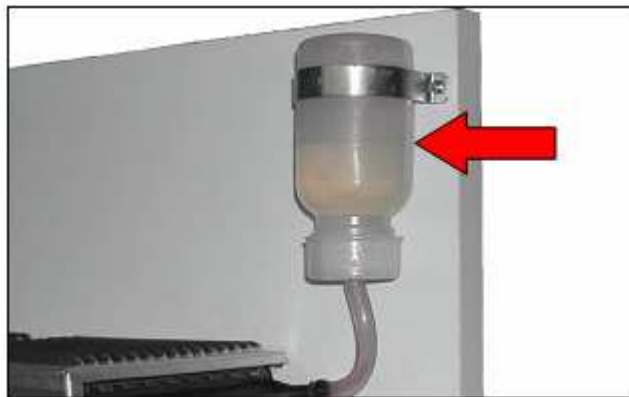
Obr. 4. Kontrola hladiny vody v expanzní nádobě
